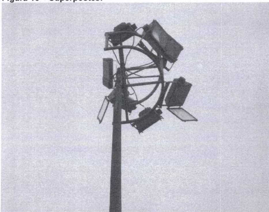
Iluminação com superposte na avenida atlântica
